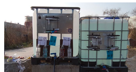
Cuve d'eau de l'association Roots, Dunkerque, février 2024 © Solidarités International
